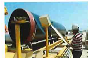
أنابيب مياه محطة شمال الزور
